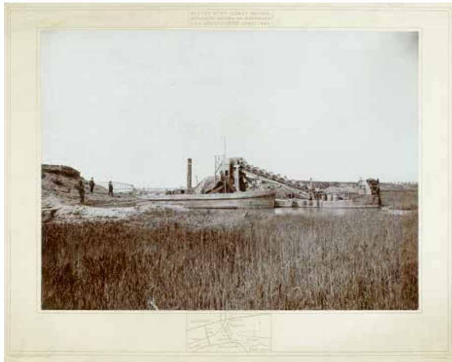
Afb. 5 Opruiming van den Aalburgschen Dijk in het kader van de scheiding van Maas en Waal, de aanleg van de Bergse Maas, 24 mei 1904. Bestek nr. 217, dienst 1903, 1905. Foto: Arnaud Pistor & Zoon. (Rijksmuseum, Amsterdam)
